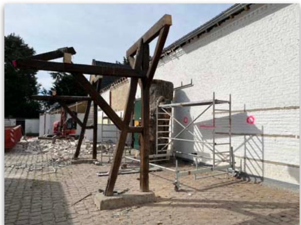
Die Sanierungs- und Abbrucharbeiten am Haus des Waldes sind schon weit fortgeschritten.
